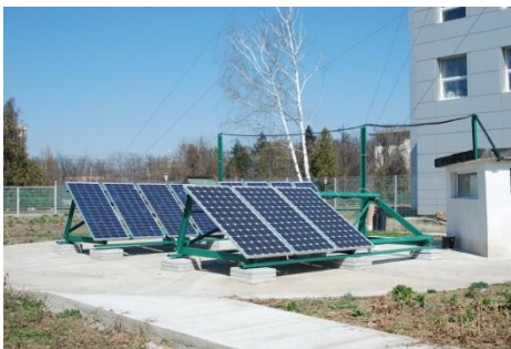
Panouri fotovoltaice pt captarea energiei solare
