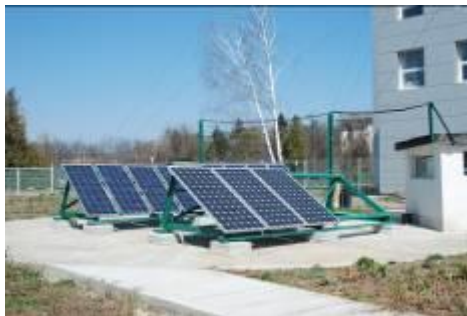
Panouri fotovoltaice pt captarea energiei solare
